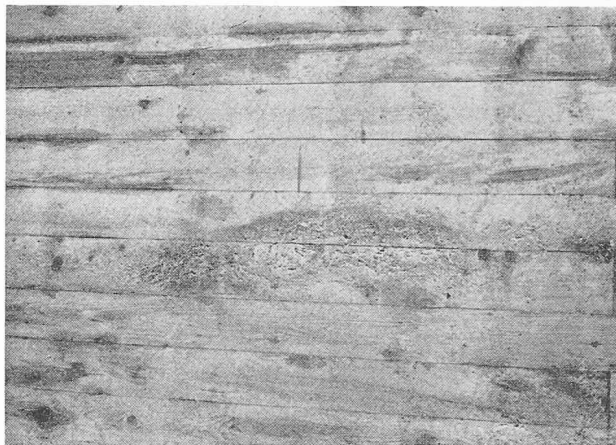
Fig. 17. — Exemples de marbrures de la surface des bétons.
