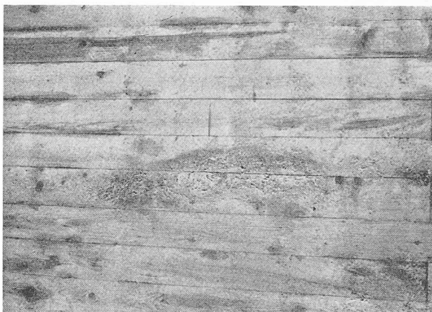
Fig. 17. — Exemples de marbrures de la surface des bétons.
