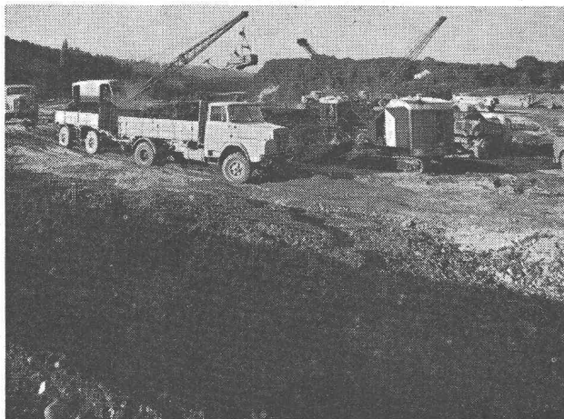
Station d'épuration de Genève au 10 octobre 1963
