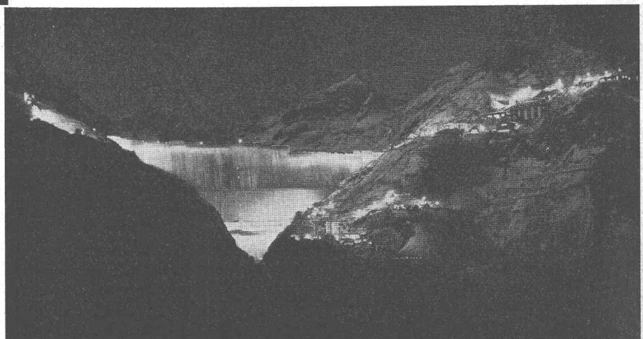
Installation d'éclairage du barrage de la Grande-Dixence (Valais), dotée de 50 projecteurs INFRANOR, Type P 1000 de 3000 W chacun
