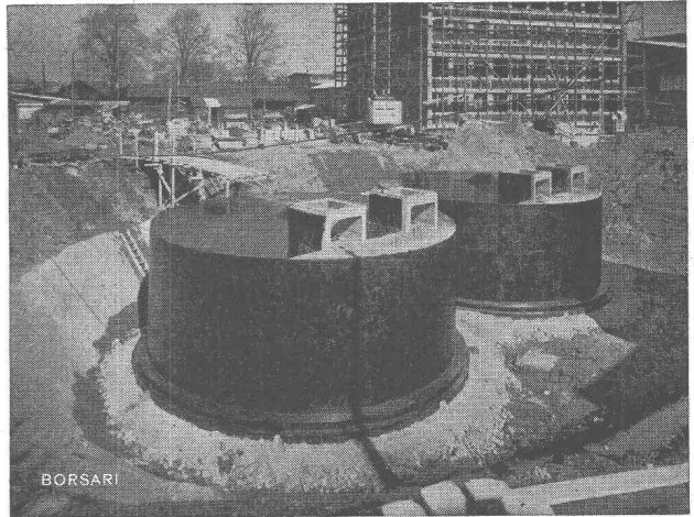
Verkehrsbetriebe der Stadt Luzern, 2 Tanks, 300'000 Liter Dieselöl.
