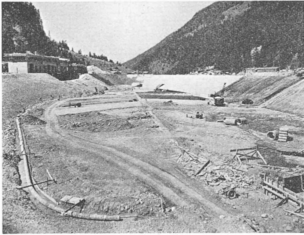
Fig. 14. — Vue d'amont vers l'aval. Etat des travaux été 1957. A gauche, drain de pied.
