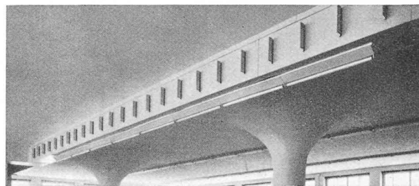
Fig. 9. — Canal à fentes installé dans une usine textile.
