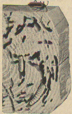
Pièce de charpente rongée par les larves d'hylotrupe
