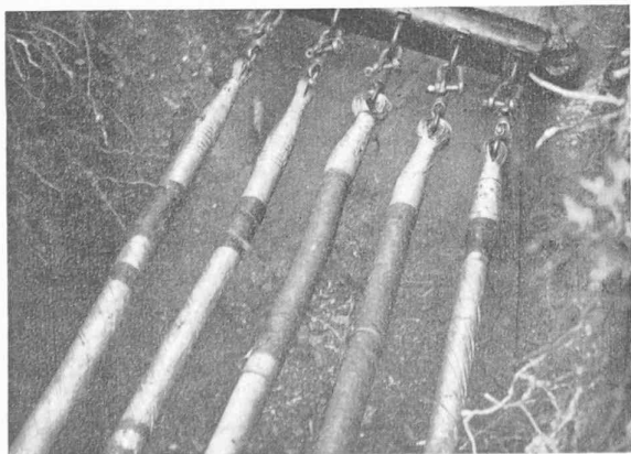
Fig. 14. — L'extrémité tirée des câbles.
