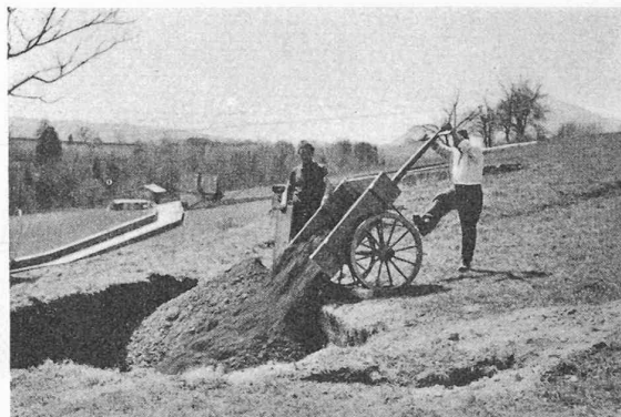
Fig. 9. — Remblayage des trous en surface. Remarquer la fissure limitant les affaissements au S.-W., à 10 m des murs de soutènement et exactement au-dessus de la limite du dépilage.
