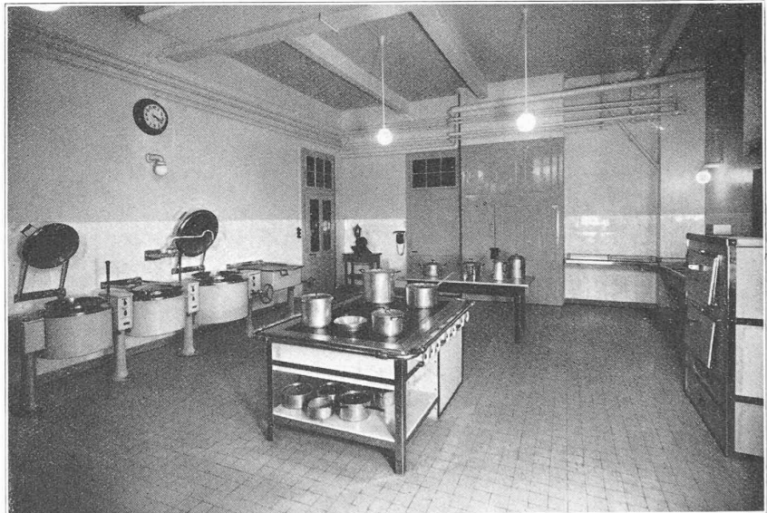
Fig. 4. — Cuisine électrique de l'Imprimerie St-Paul, à Fribourg.
