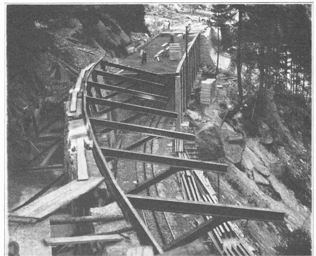
Fig. 1. — A Täschwand (km. 31,7 environ). De la galerie de protection à colonnes, on passe à la galerie sous consoles métalliques ancrées dans des massifs contre-poids en béton.
