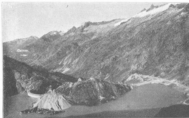
Les deux barrages du Grimsel en construction. A gauche, celui de la Spitallam. A droite, celui de Seeuferegg.
