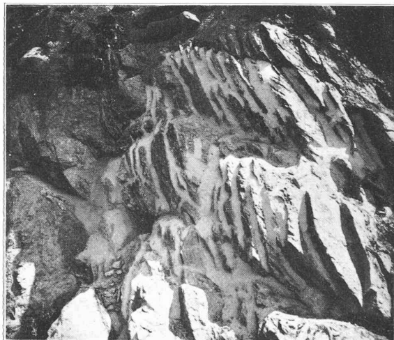
Retenue de Monte-Jaque. Jointoyage au mortier de fissures du calcaire. (Cliché M. Lugeon.)
