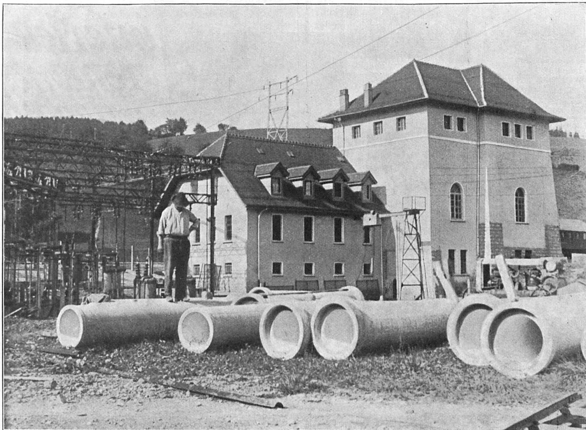
Sous-station de Puidoux des C. F. F., canalisation de 500 mm., en tuyaux Vianini, posée à une profondeur de 7 mètres en terrain marneux.
