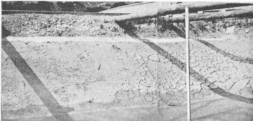
Fig. 4. — A gauche : béton de terre glaise compact. A droite : couche de terre glaise fissurée sur un talus de sable du bassin à ciel ouvert.
