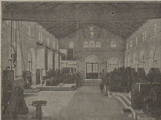
Usine d'électrochimie de Martigny. — Local des turbines.
