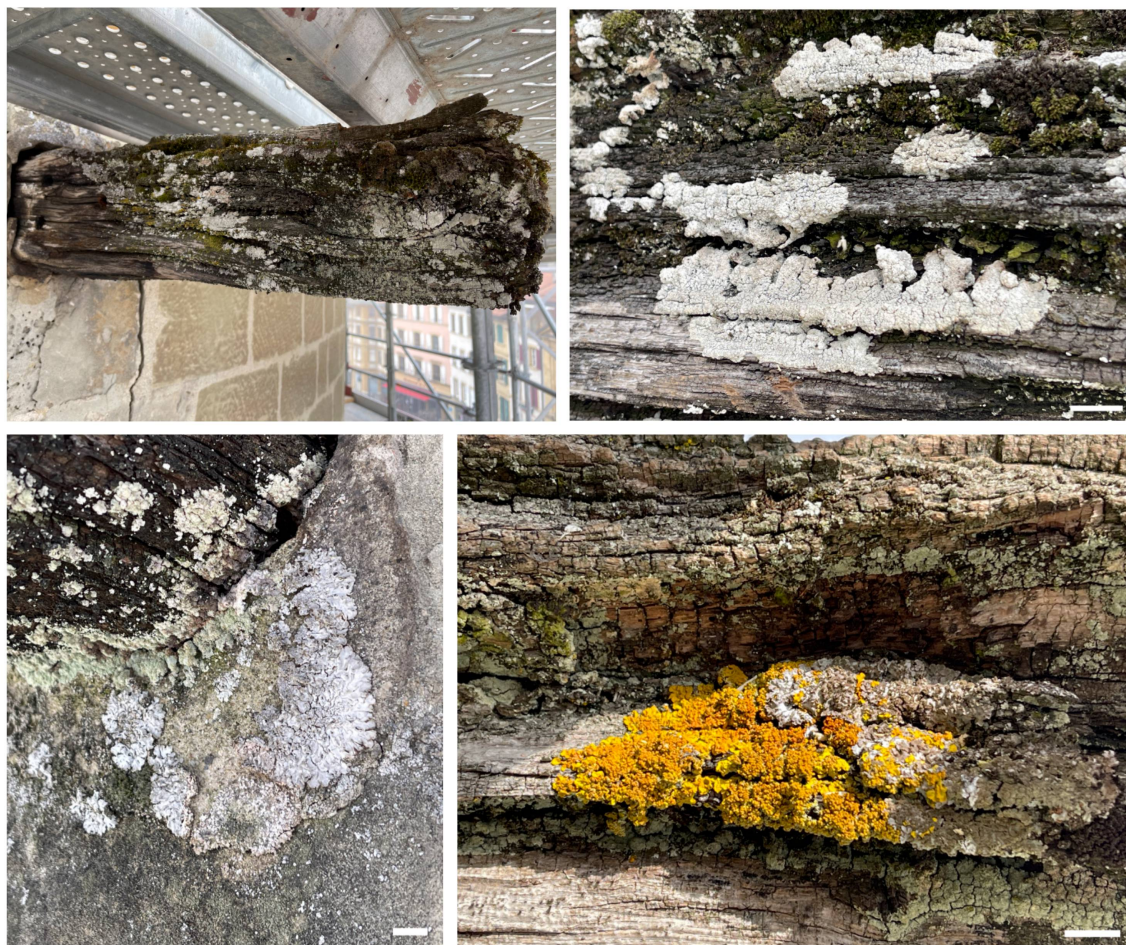
Figure 5. Les microhabitats de la tour: le hourd. Les restes des poutres du hourd sont en décomposition avancées, mais encore solides. La présence de Diploschistes scruposus est étonnante habituellement liée aux rochers siliceux, en haut à droite. Les dessous des poutres est colonisé par les Lepraria , lichens pulvérulents verdâtres spécialistes des habitats à l'abri de la pluie, en bas à gauche. Les lichens foliacés orange, Xanthoria calcicola , et gris brunâtre, Physconia grisea , sont nitrophiles, indiquant que ces poutres ont aussi servi de perchoirs aux oiseaux, en bas à droite. Les barres d'échelle correspondent à 1 cm.
