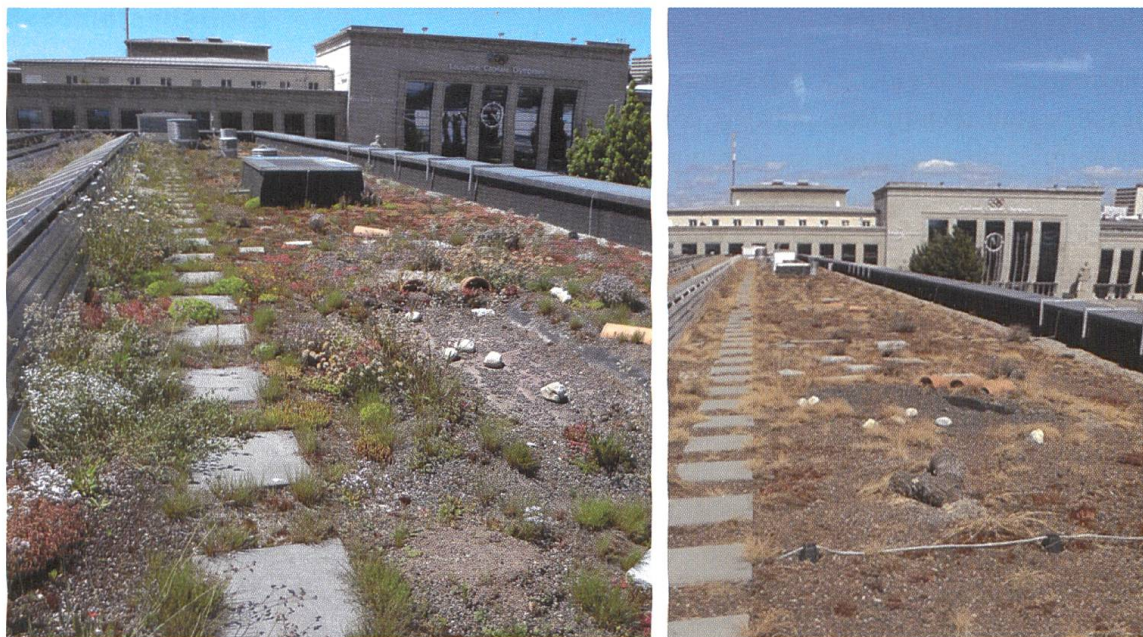
Figure 4. Comparaison saisonnière de la végétation sur la toiture de Beaulieu; fin mai (photo de gauche), la diversité florale est importante; fin juillet (photo de droite), la sécheresse et la chaleur ont eu raison de la plupart des plantes et les ressources en nectar et pollen se font extrêmement rares.
