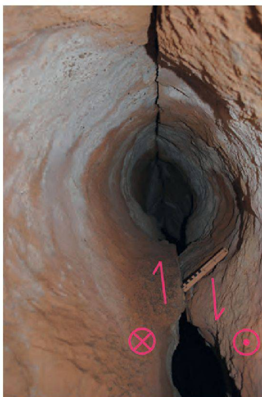
Figure 7.—Cisaillement par néotectonique d'un conduit de la grotte, à axe vertical, proche de l'entrée. Photo prise en direction de l'est. Le déplacement des deux compartiments se monte à quelques centimètres (échelle totale: 20 cm). Le compartiment de droite (sud) s'est abaissé et a avancé vers le lecteur; celui de gauche est monté et s'est éloigné du lecteur. C'est donc un décrochement dextre.
