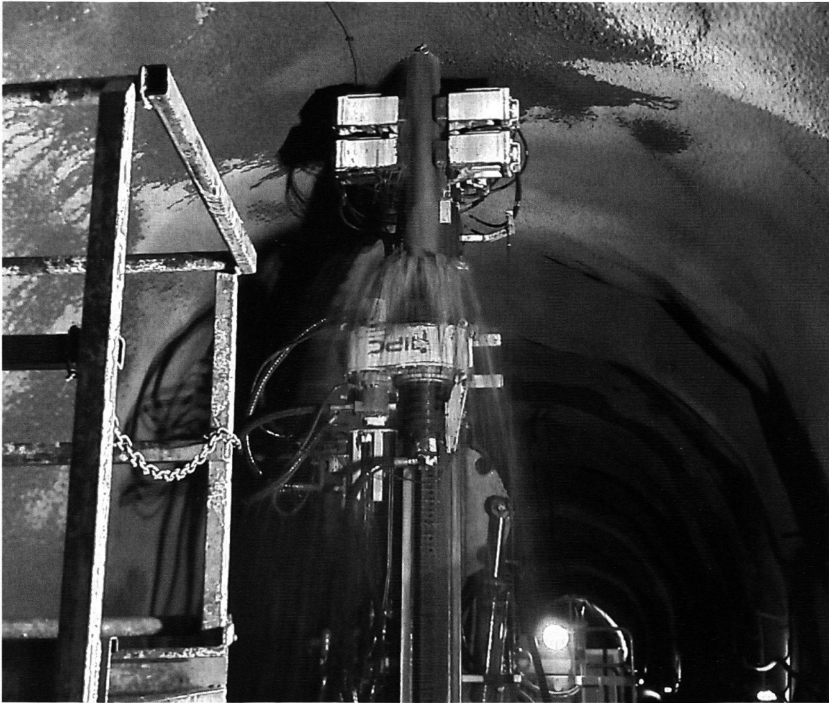
Figure 3.—Forage des drains remontants à partir de la galerie de drainage sous le glissement de La Frasse; les débits sont momentanément importants en cours de forage, mais se sont fortement réduits (photo extraite de SOLDINI et al. 2009).
