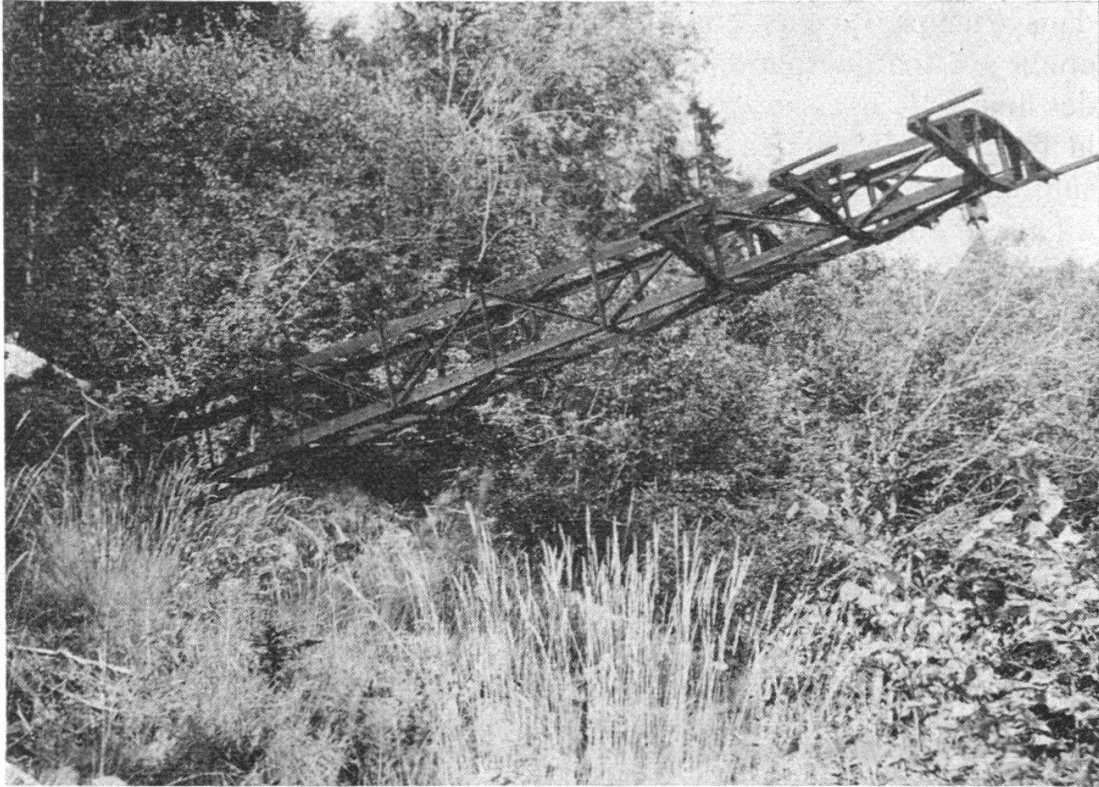
Fig. 3. — Pylône basculé par le glissement des Fontanelles.
