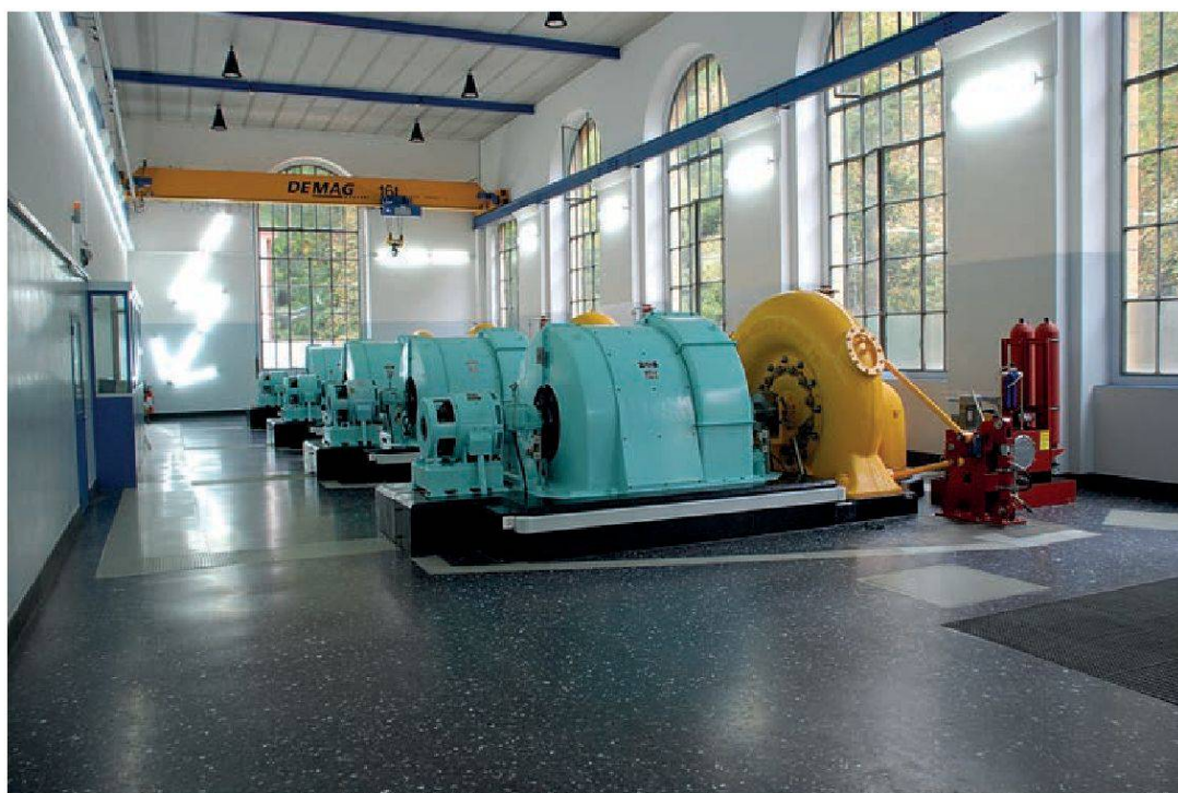
Intérieur de l'usine du Chanet à la sortie des Gorges de l'Areuse (production d'électricité)
