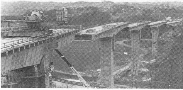
Photo 3 : Vue d'ensemble des fléaux avant basculement
