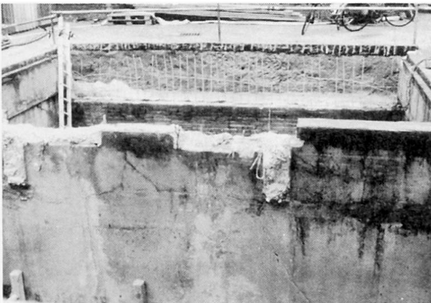
Bild 1: Salzlösegrube nach dem Abstemmen der Abdeckplatten
