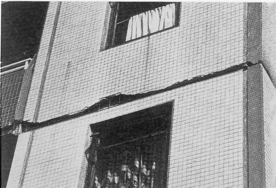
Bild 7 Betonabplatzung im Bereich offener Horizontalfugen infolge Korrosion der Bewehrung
