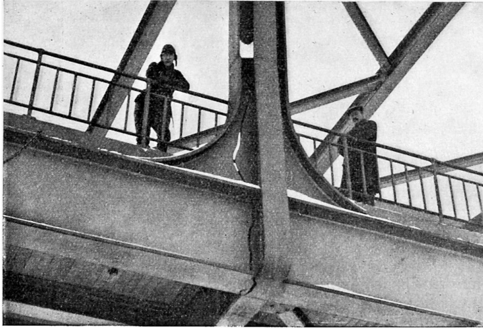
Fig. 2. Rupture dans une poutre, composée par soudure, constituant membrure inférieure, à la jonction avec une entretoise et avec un montant.
