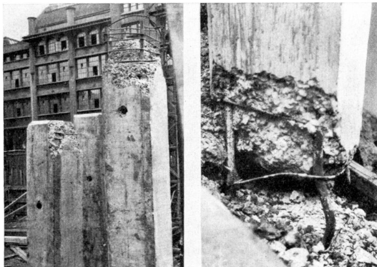
Fig. 1. Exemples de détérioration de pieux en béton armé.
