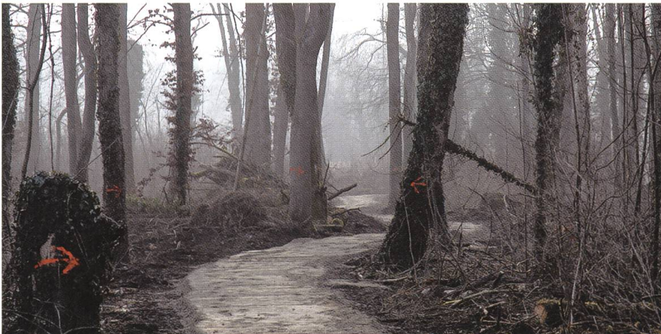
Gestaltung des neuen Wanderweges, die Pfeile führten den Bagger durch den Wald.
