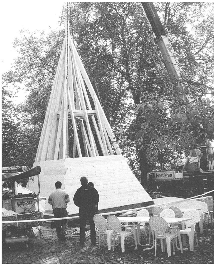
Mit dem Aufsetzen des 9,4 Meter hohen Turmhelms nähern sich am 17. Oktober die Sanierungs- und Umbauarbeiten des Katzenturms ihrem Abschluss.
