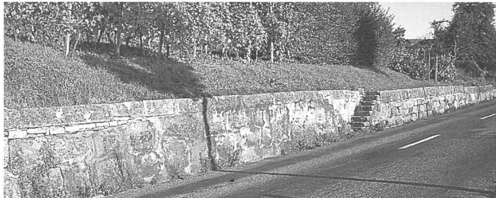
Abb. 2: Alte Rebmauer an der Kantonsstrasse von Niederrohrdorf. Hier verschwand vor 50 Jahren das einzige damals im Reusstal bekannte Vorkommen des Rötlichen Mauerpfeffers infolge einer Mauervermörtelung. (Aufnahme 1998)
