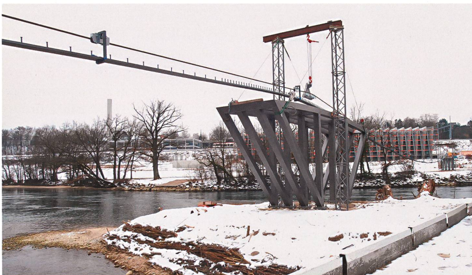
März 2010: Das erste Spannband des Fussgängerstegs Schachen-Mülimatt wird über die Aare gezogen Foto: Walter Schwager, Aargauer Zeitung
