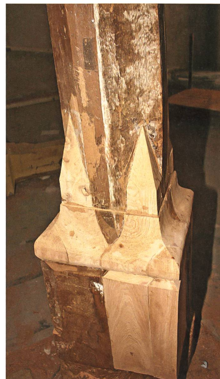
Detailansicht eines Eichenpfeilers 2010. In den 1950er-Jahren rücksichtslos abgesägte Teile wurden nun sorgfältig ergänzt
