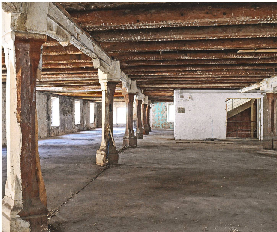
Blick in einen Teil der ehemaligen «Kornschütte» (2. Stockwerk). Die zuvor verdeckte Balkendecke und die eichenen Pfeiler sind wieder freigelegt. Die ganze Halle wurde von zwei weiteren Pfeilerreihen (rechts) getragen. Im Hintergrund das 1927 eingebaute Treppenhaus. Bei Vollbelegung reichte das hier aufgeschüttete Getreide bis zu den Fenstersimsen und musste regelmässig belüftet und umgeschaufelt werden Foto: Marcel Werren, Brugg
