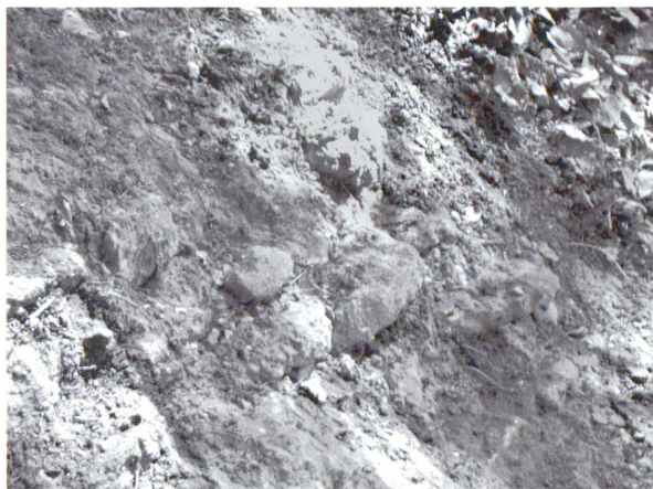
Fig. 24. La voûte affleurante de l'aqueduc de Coppet dans la pente au point C.P.36.
