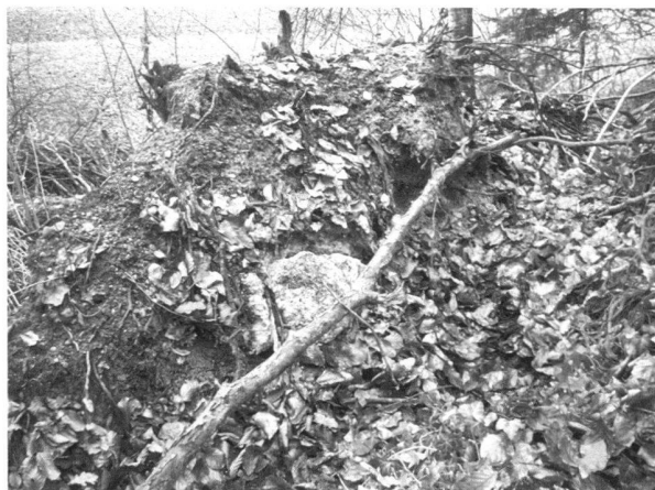
Fig. 19. Photo de l'arbre couché ayant emporté des claveaux de l'aqueduc de Coppet dans ses racines au point C.P.30.
