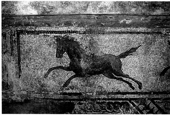
Fig. 12. Orbe-Boscéaz. Travaux de conservation-restauration de la mosaïque des Divinités. Au centre du cheval: effondrement d'une « cloque ». Photo MRA.
