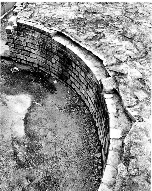
Fig. 7. Une alvéole du mur périmétral du secteur ouest. Une série de moellons doit être remplacée. Photo MRA.
