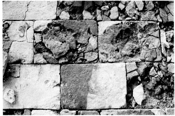
Fig. 3. Exemple de dalles en terre cuite dégradées. Photo MRA.
