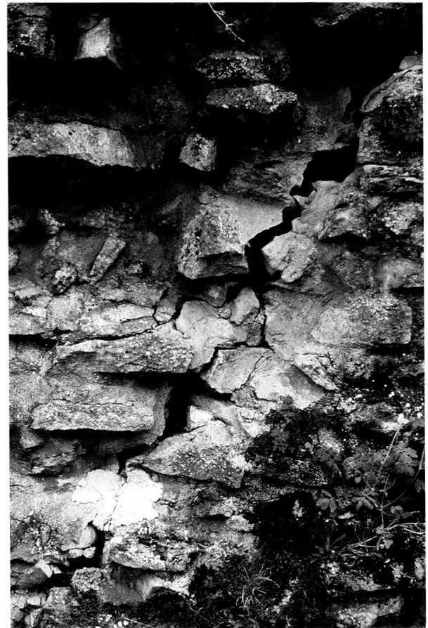
Fig. 12. Fissure du mur d'enceinte due à un affaissement. Photo MRA, mai 2001.
