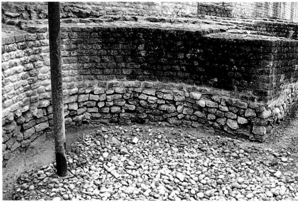
Fig. 9. Une alvéole du mur périmétral du secteur nord-est. La partie basse doit être rejointoyée. Photo MRA.
