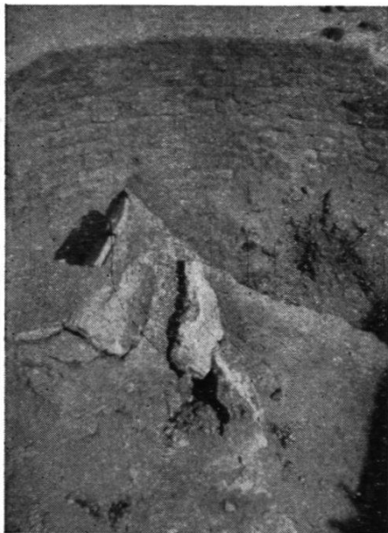
Fig. 11 — Intérieur de B. Plafond effondré avec dallage de marbre
