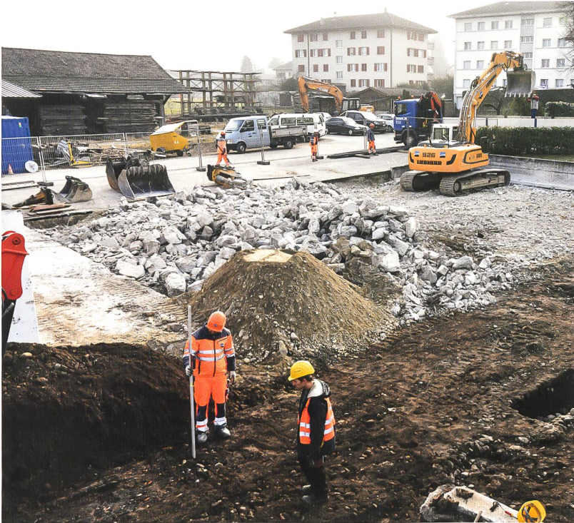
Fig. 21 (à g.) 2016.05. Insula 2. Apparition des vestiges sur la zone investiguée et, au deuxième plan, démolition de la dalle en béton sur laquelle reposaient les silos aménagés vers la fin des années 1990.
