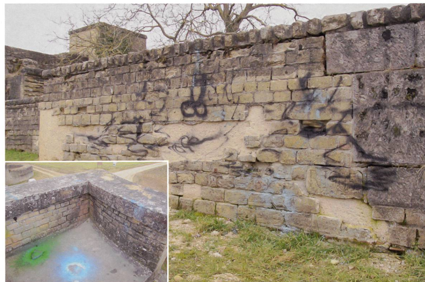
Abb. 3 (oben) Thermen En Perruet. Monumentenbegehung April 2014. Vandalismusschäden an der Infrastruktur; mutwillig zerstörtes Informationspanneau und verbogene Verankerung bei der mobilen Schutzwand im Nordosten.
