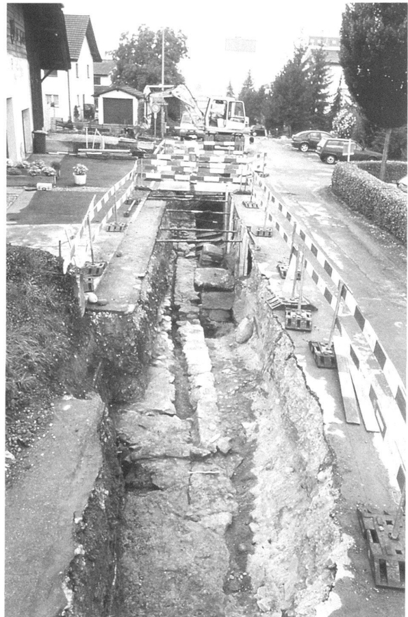
Fig. 12. Avenches/Insulae 13-14, voirie. Vue du mur accolé au piedroit oriental de l'égout collecteur ainsi que des deux piles découvertes à l'angle sud-est de l' insula 14.
