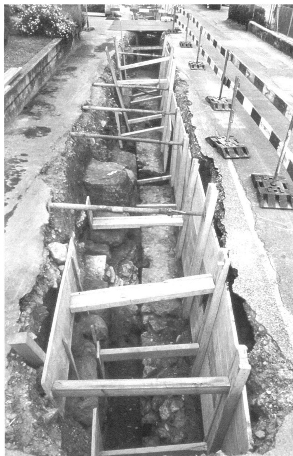
Fig. 16. Avenches/Insula 19. Les vestiges des locaux de service partiellement dégagés dans la tranchée ouverte à la route du Moulin. Vue du sud.
