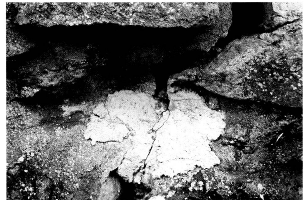
Fig. 13. Témoin de mortier posé en avril 2000. La fissuration du témoin illustre la progression de l'affaissement de ce secteur du mur d'enceinte. Photo MRA, mai 2001.
