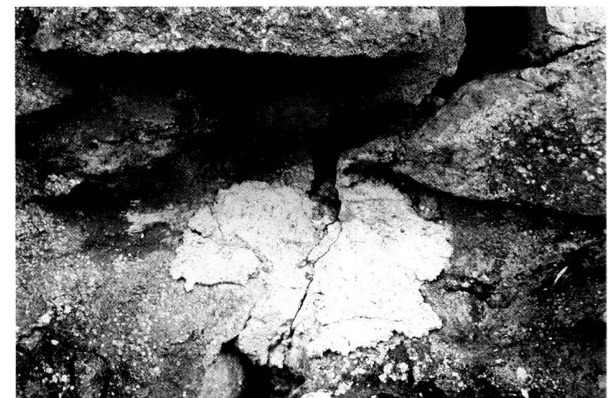
Fig. 13. Témoin de mortier posé en avril 2000. La fissuration du témoin illustre la progression de l'affaissement de ce secteur du mur d'enceinte. Photo MRA, mai 2001.
