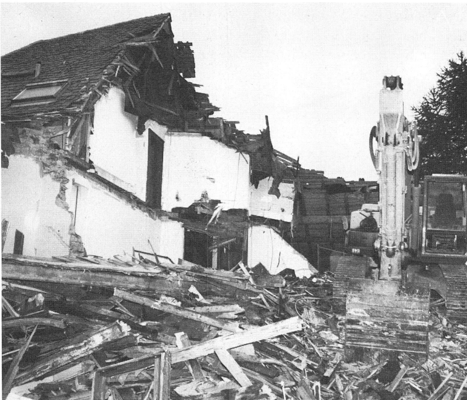
Abb. 5: St. Moritz: Villa Böhler von Heinrich Tessenow, 1989 abgerissen.
