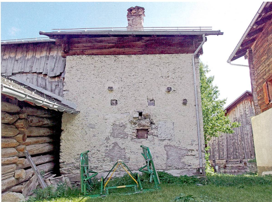
In der Mitte der Nordfassade zeugen zwei Öffnungen vom ursprünglich vorhandenen, aussen angesetzten Backofen der Küche (Foto: Sara Bonderer, Haldenstein).
