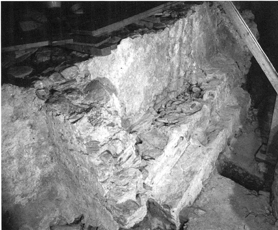
Tomils, Sogn Murezi. Entlang der Ostwand liegen die Reste der hierarchisch gegliederten Klerusbank bestehend aus einer gemauerten Sitz- und Fussbank. Blick nach Südosten (Archäologischer Dienst Graubünden).
