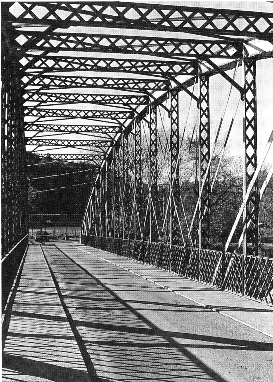
Das Fach- und Strebewerk der Bogenbrücke zeichnet geometrische Ornamente in den Himmel, Foto: Heini Letsch, Tamins.
