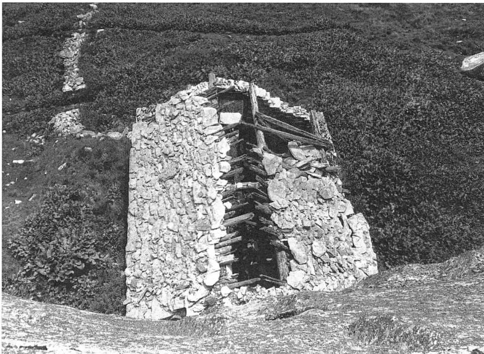
Abb. 9: Stark beschädigtes Dach eines «Stalles»; Etzmeder
