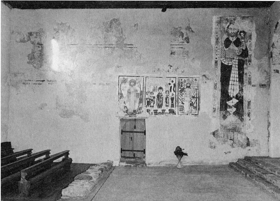
Abb. 1: Mistail, St. Peter: Nordwand. Male- reifragmente aus karolingischer Zeit und Wand- malereien aus dem 15. Jahrhun- dert. Zustand 1981, nach der Restaurierung.
