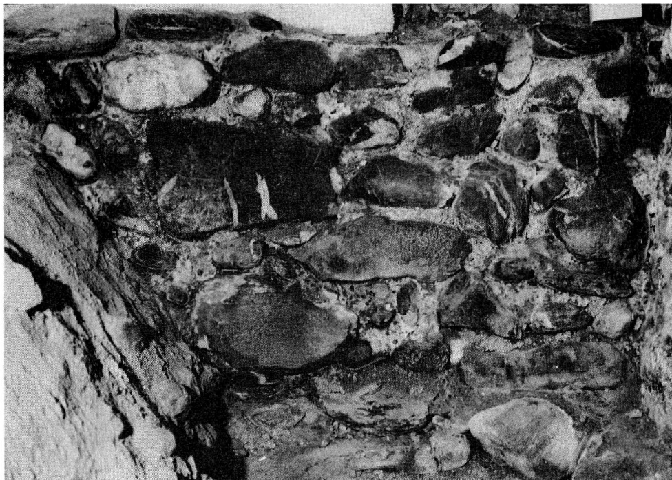
Abb. 6: Chur, Kapelle St. Stephan: Tonne von oben an der Südseite mit Erweiterungsan- schluss, der Feuchtigkeit bringt.
