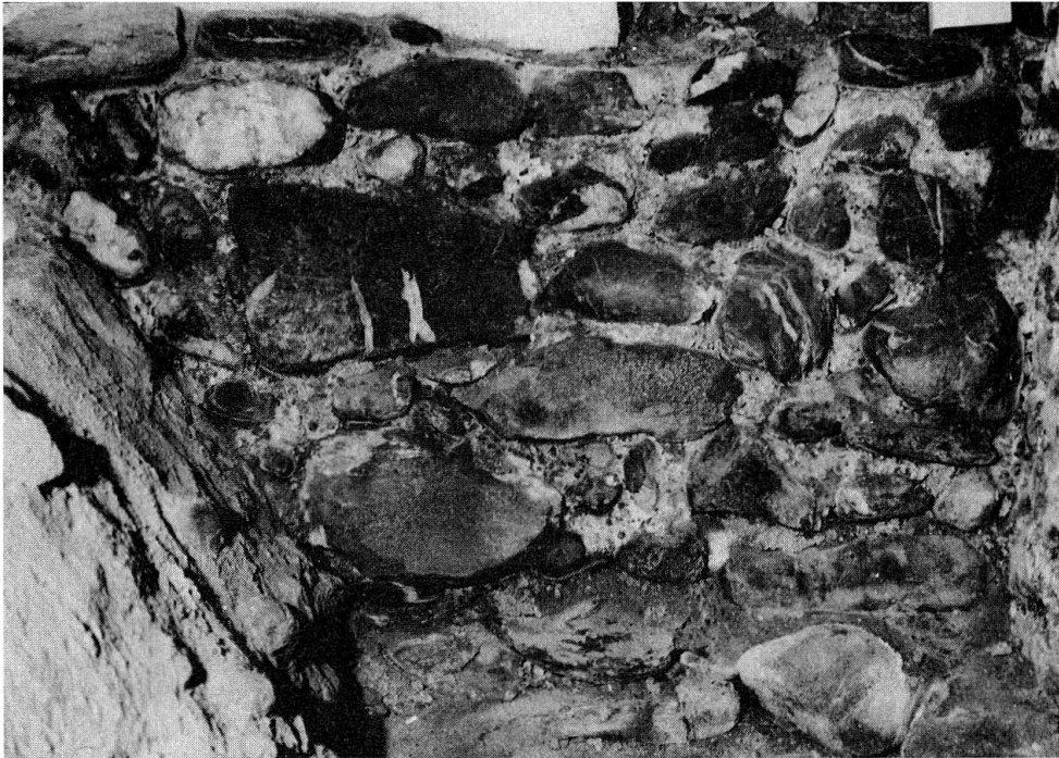
Abb. 6: Chur, Kapelle St. Stephan: Tonne von oben an der Südseite mit Erweiterungsanschluss, der Feuchtigkeit bringt.
