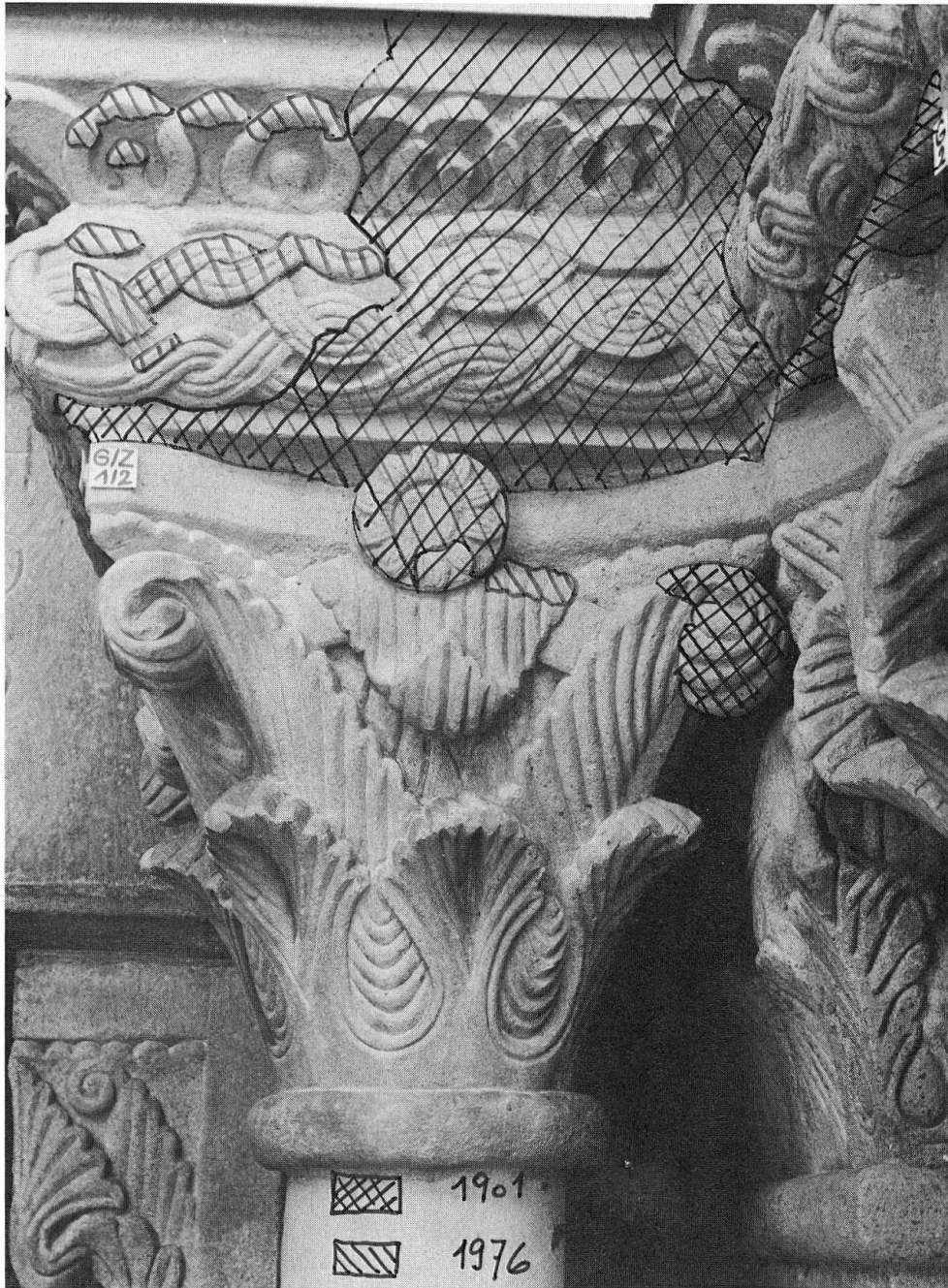
Abb.4: Wichtig ist das Dokumentieren der Restaurierungsarbeiten: dieses Kapitell wurde 1901 und 1976 mit Mörtel ergänzt; diese Ergänzungen sind hier schraffiert eingezeichnet. Die unschraffierten Flächen sind aus Sandstein.
