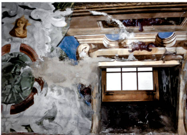
Durch Feuchtigkeit (Infiltration) bedingte Erosion (bis hin zu vollständigen Verlusten) bei der Voute der Westseite.
