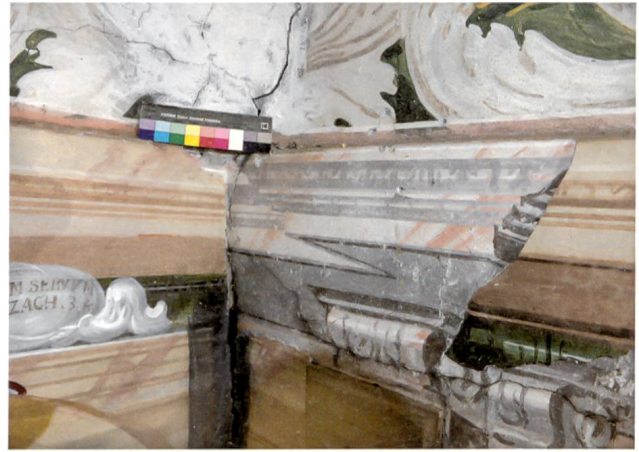
Offen liegende Partien des älteren Bestandes (NW-Ecke) mit später aufgezogener zweiter Putzschicht.
