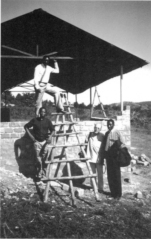
Das erste Gebäude entsteht Ende 1993, südlich Kampalas (Uganda): Daraus soll das College der RPCU werden! Die Übertragung der Grundstücksrechte an die juristisch noch nicht gegründete Institution ist mündlich zugesichert. Alle hoffen. Rechts Joseph Musiitwa und Peter Rudolf. (Foto JK)
