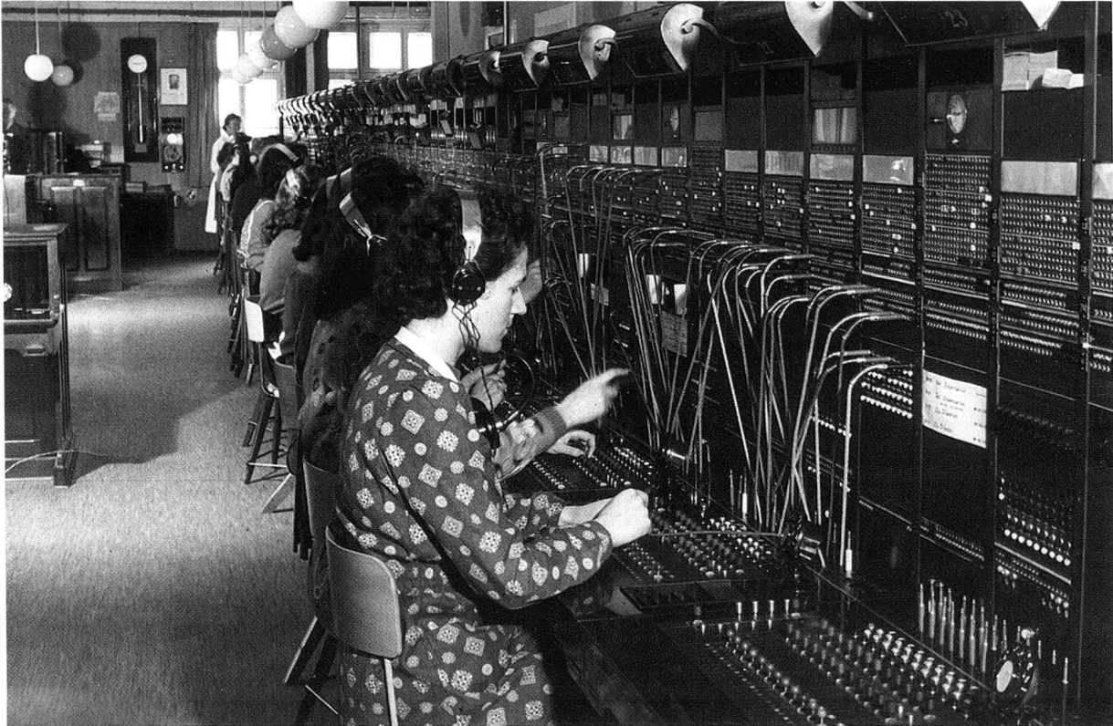
Die St. Moritzer Zentralbatterie-Zentrale, 1929–1952. (Foto: Telecom PTT Chur).
